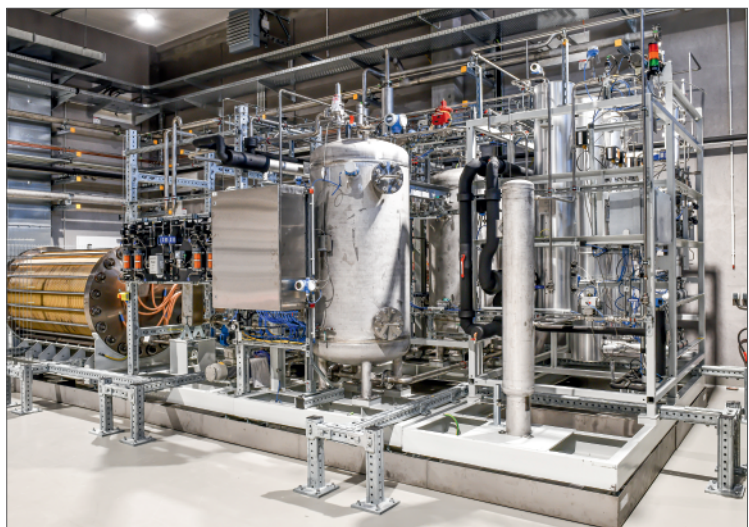
Elektrolyseur und Gasaufbereitung der Power-to-Gas-Anlage auf dem Kraftwerksgelände in Wyhlen
