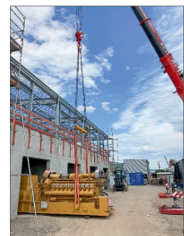
Im Juni 2022 wurden die BHKW-Module angeliefert
