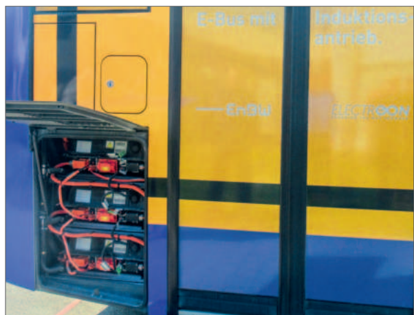
Die LFP-Batteriemodule sind modular eingebaut. Jedes bringt 200 Kilogramm auf die Waage
