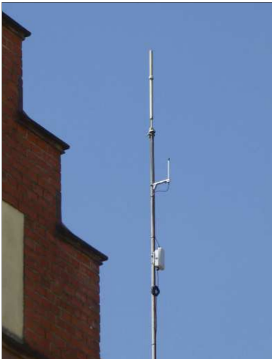
LoRaWAN-Gateway auf einem Gebäudedach
