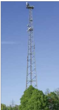
Funkmast der Netze BW auf dem Gelände des Um- spannwerks Eichstetten
